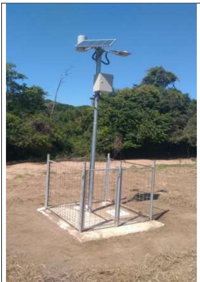
Foto 5 - Estação Telemétrica Limpa (perto).
