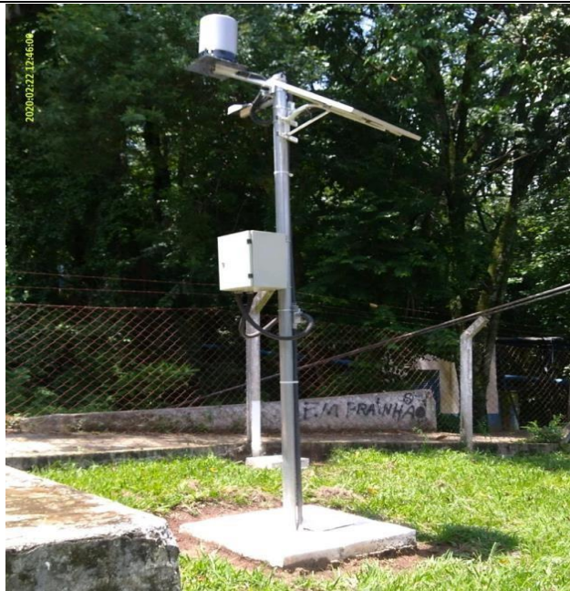
Foto 20 - Estação Telemétrica Limpa (longe).
