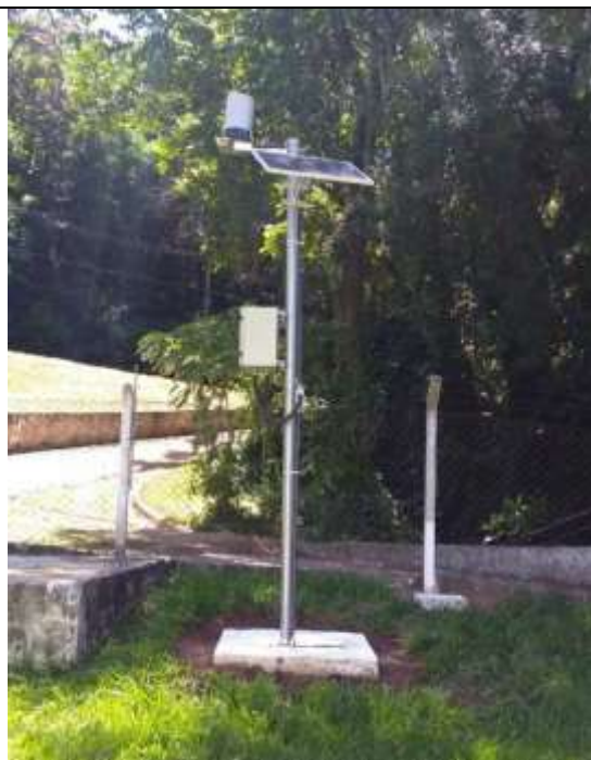
Foto 20 - Estação Telemétrica Limpa (longe).
