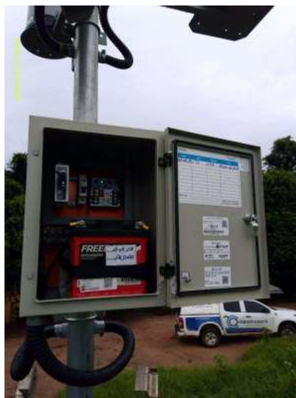
Foto 10 - Estação Telemétrica Limpa (perto)
