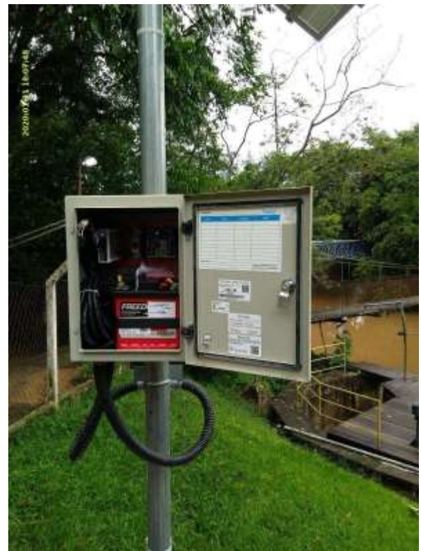
Foto 25 - Estação Telemétrica Limpa (perto)
