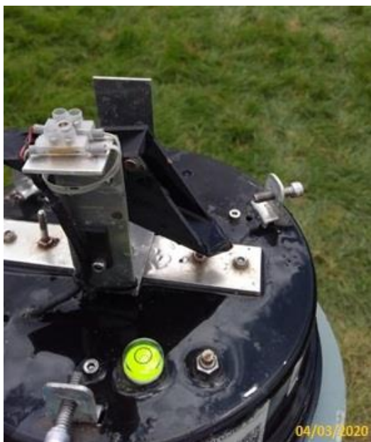
Foto 13 – Vista do pluviômetro após a manutenção e limpeza - 7°C (Data: 04/03/20).
