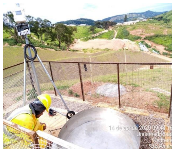
Foto 5 – Detalhe da manutenção da estação. (Data: 14/04/20).
